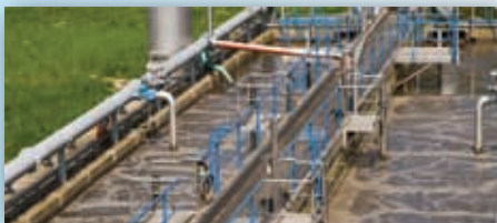
STAȚII DE EPURARE A APEI
