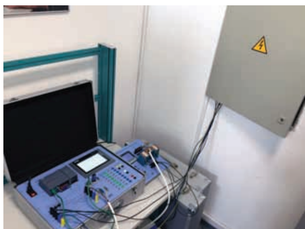
Figura 2. Sistem cu echipamentul de monitorizare montat
