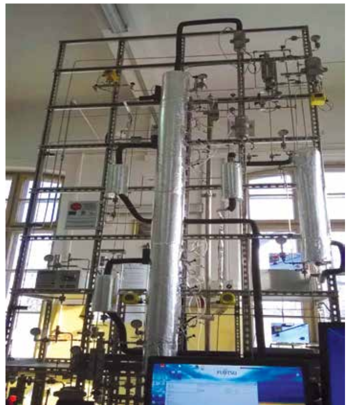
Fig. 6: Instalația pilot de distilare reactivă
